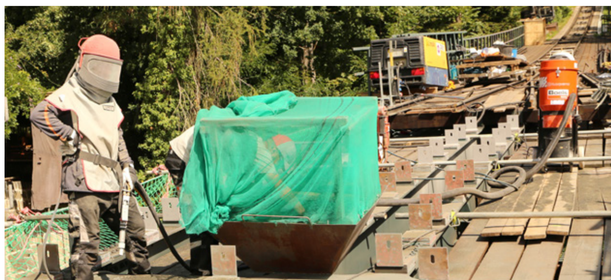
Was hier aussieht wie eine Figur aus den Star-Wars-Filmen, ist in Wirklichkeit ein Mitarbeiter der Firma Fuchs, der das Viadukt mit Sandstrahlverfahren zur Aufnahme der neuen Tragbalken für die Schienen vorbereitet.
